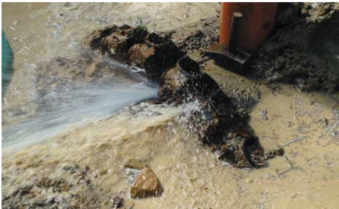
Fot. 1. Przykład utraty szczelności nasuwki kompensacyjnej wodociągu magistralnego
