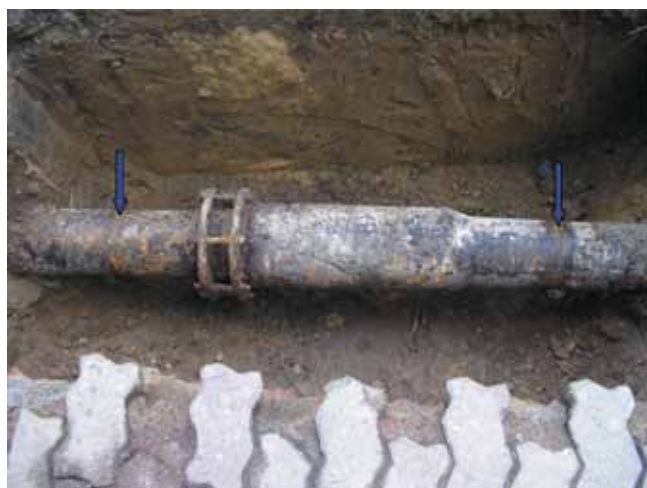
Fot. 2. Kompensator w gazociągu stalowym niskiego ciśnienia DN200, złącza rur spawane
