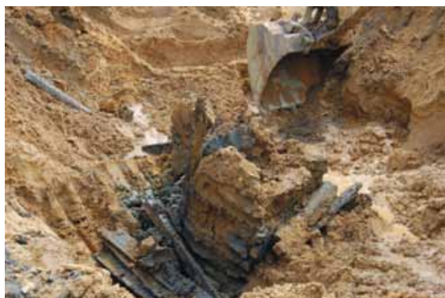
Rys. 1. Zasypany rodzimym gruntem szyb w obszarze występowania złóż cynku i ołowiu w Bytomiu-Dąbrowie
