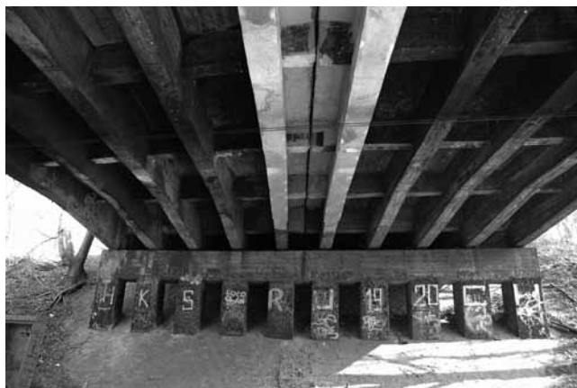
Rys. 4. Widok wiaduktu od spodu, od strony północnej, widoczne główne elementy konstrukcyjne: podłużne belki główne, poprzecznice oraz filary Fig. 4. View of the bridge from below, from the north, the main structural elements are visible
