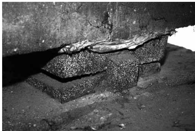
Rys. 6. Jedno z łożysk stycznych przed usunięciem ograniczników przesuwu poprzecznego
