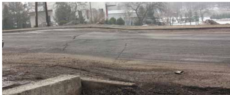
Rys. 14. Deformacja krawężnika jezdni – przypadek C (fot. Grygierek M.) Fig. 14. Kerb deformation – case C (photo Grygierek M.)
