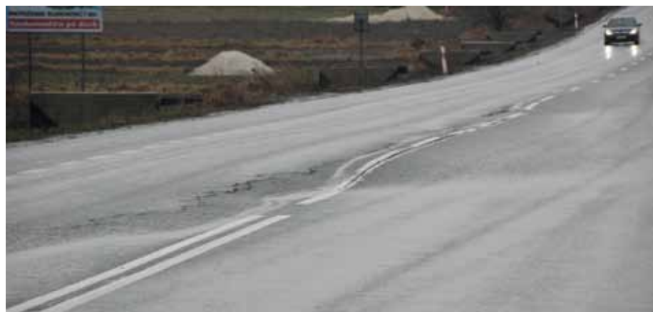
Rys. 7. Sfałowania, lokalne zagłębienia nawierzchni (fot. Chlipalski K.)
