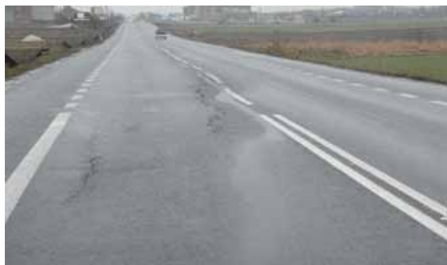
Rys. 6. Spękania i sfałowania nawierzchni – przypadek B (fot. Chlipalski K.)
