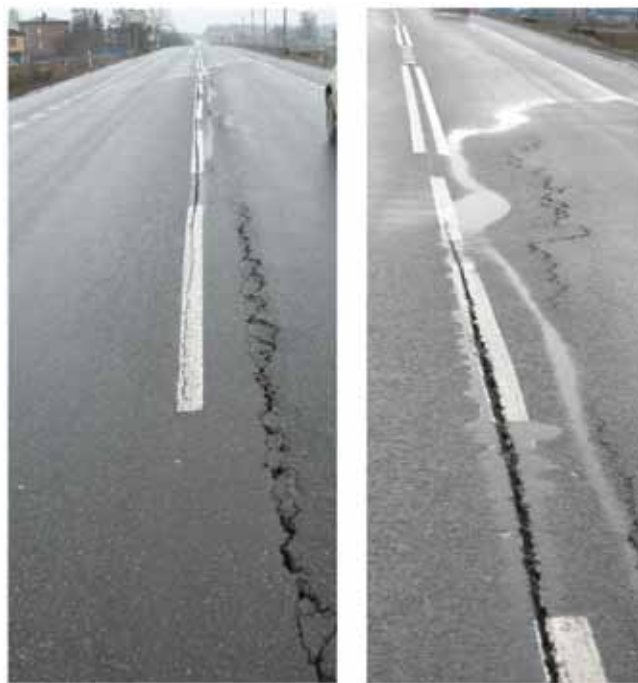
Rys. 8. Spękania, rozwarstwienie szwu technologicznego (fot. Chlipalski K.)
