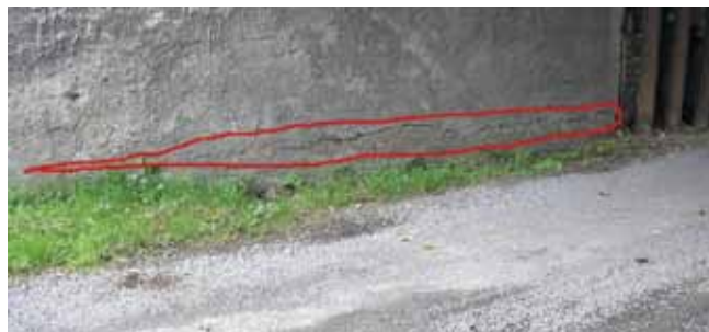
Rys. 6. Wiadukt żelbetowy – rysa pozioma na ścianie bocznej [9] Fig. 6. Concrete viaduct – horizontal crack on sidewall [9]
