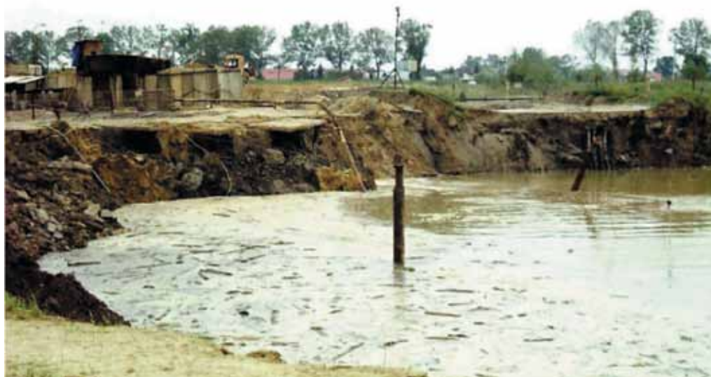
Rys. 22. Zapadlisko nad kawerną solną w Łęzkowicach, XI. 2001 r.
