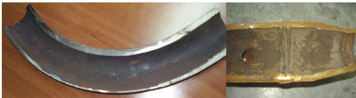
Rys. 1. Elementy rurociągu zniszczone przez korozję. Autor D. Bęben Fig. 1. Items of the pipeline damaged by corrosion. Author D. Bęben
