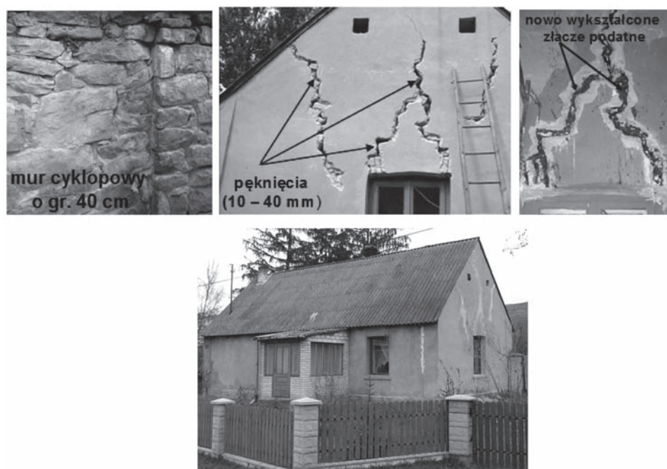
Rys. 7. Naprawa (przy użyciu polimerowego złącza podatnego) popękanego budynku murowanego z kamienia, uszkodzonego w wyniku nierównomiernych osiadań po powodzi [5] Fig. 7. Repair (by use of polymer flexible joint) of the cracked masonry building made of stone, damaged by uneven settlements after a flood [5]
