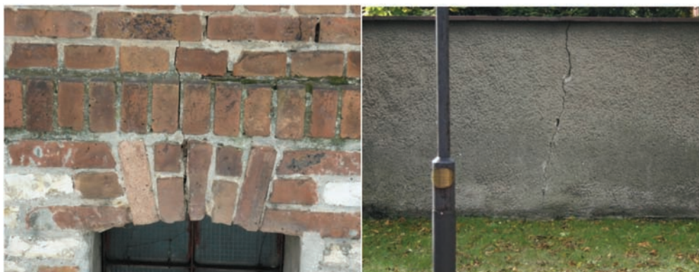
Rys. 2. Uszkodzenia spowodowane wstrząsem górniczym: pęknięcie nadproża w budynku murywanym w Chelmie Śląskim [10] – a, pęknięcie muru przykościelnego w Rydułtowach [10] – b
