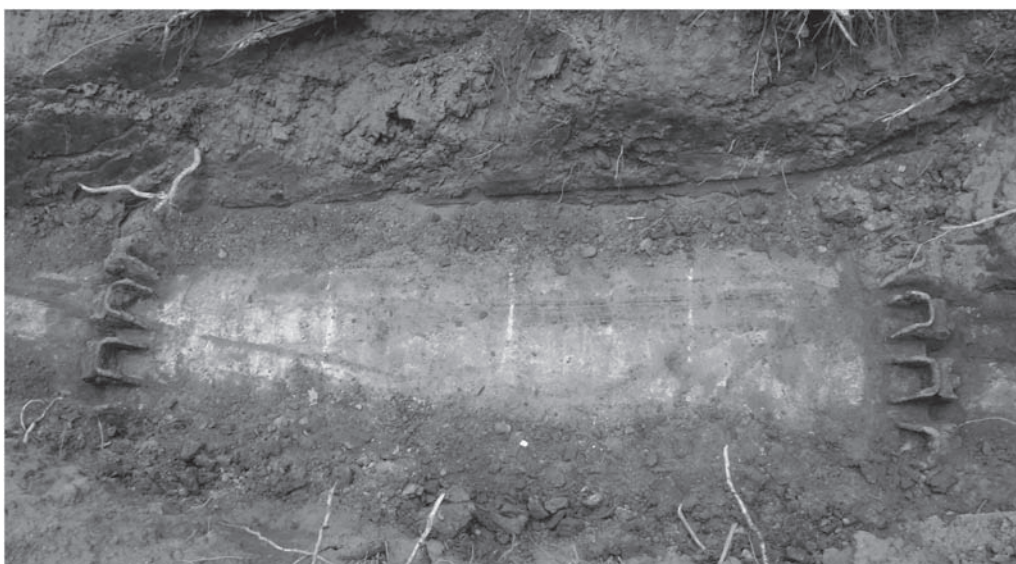
Rys. 4. Dwustronna nasuwka kompensacyjna zamontowana na sieci wodociągowej. Źródło: Opracowanie własne
