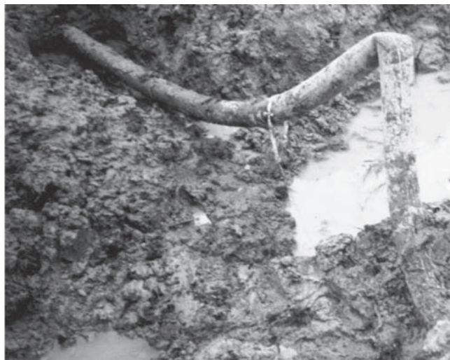
Rys. 11. Wybożenie i zatrzymanie przepływu w rurociągu polietylenowym w strefie ściskania gruntu [4] Fig. 11. Buckling and flow stoppage in polyethylene pipeline within the zone of soil compression [4]
