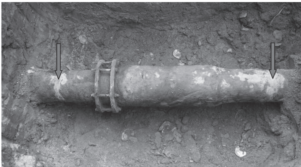
Rys. 6. Kompensator dławkowy zamontowany na sieci gazowej. Źródło: Opracowanie własne Fig. 6. Gland compensator mounted on the gas pipeline. Source: Own elaboration
