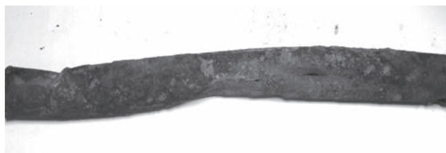
Rys. 9. Deformacja i korozja wodociągu stalowego w strefie ściskania warstwy gruntu. Źródło: Opracowanie własne Fig. 9. Deformation and corrosion of steel water pipeline within the zone of soil layer compression. Source: Own elaboration
