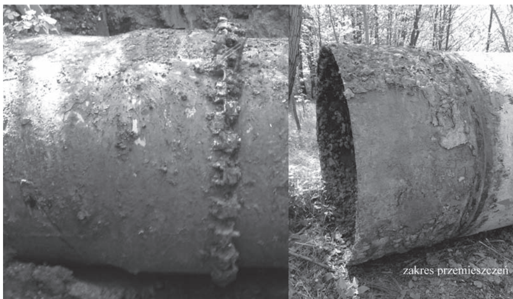
Rys. 5. Jednostronna nasuwka kompensacyjna zamontowana na sieci wodociągowej (z lewej) i koniec rury zdemontowanej nasuwki po kilkudziesięciu latach pracy. Źródło: Opracowanie własne
