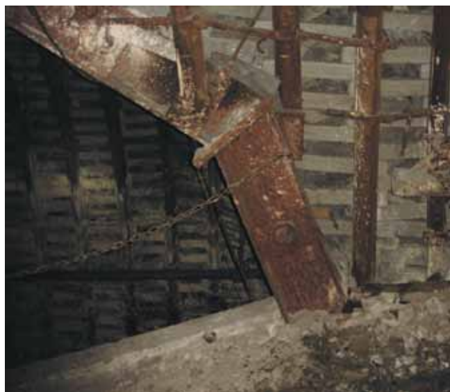
Rys. 10. Widok belek wspornika ze strony pochylni odstawczej. Widoczne wsporniki do posadawiania odrzwi uzupełniających.
