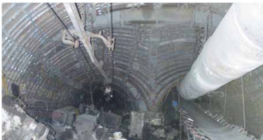
Rys. 15. Obudowa odgałęzienia przekopu kierunkowego pod pokładem 510 poz. 774 m z przekopem odstawczym 774/585 w końcowym etapie zabudowy w wyrobisku [1]
