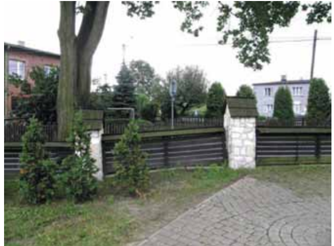
Fot. 8. Deformacje ogrodzenia terenu parafii przy kościele Photo 8. Fence deformations of the parish church area
