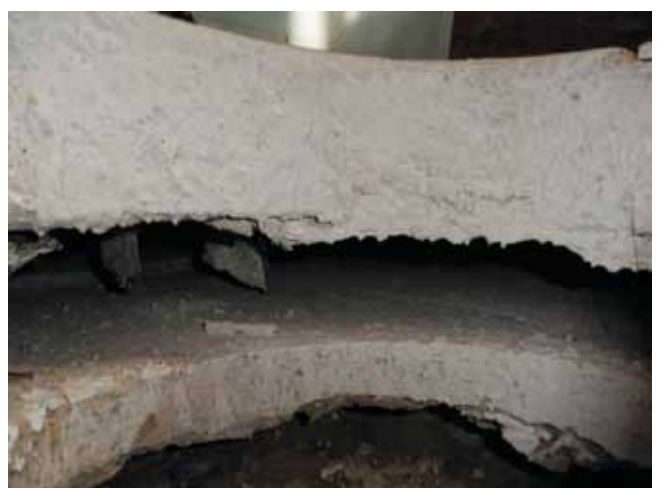
Fot. 10. Rozwarstwienie między żelbetową płytą grubości 12 cm a nową warstwą betonu o średniej grubości 15 cm Photo 10. Stratification between the reinforced concrete slab with thickness of 12 cm and a new concrete layer with an average thickness of 15 cm
