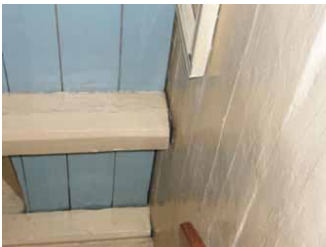
Fot. 7. Ślady wysunięcia się belek nośnych dolnego podestu chóru ze ściany kościoła Photo 7. Displacement traces of carrying beams of lower choir platform from the church wall
