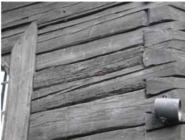
Fot. 6. Rozluźnienie belek wypełnienia ściany prezbiterium Photo 6. Beams loosening of wall filling of the presbytery
