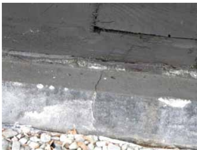
Fot. 4. Pęknięcie płyty przepony Photo 4. Rupture of membrane plate
