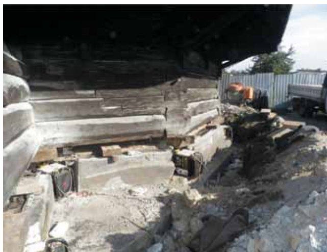
Fot. 11. Siłowniki zabudowane poniżej drewnianych zabytkowych elementów konstrukcji budynku kościoła Photo 11. Servomotors placed below the historical wooden construction elements of the church
