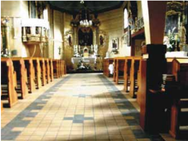
Fot. 5. Deformacje (wygięcie) posadzki kościoła Photo 5. Deformations (bending) of the church floor
