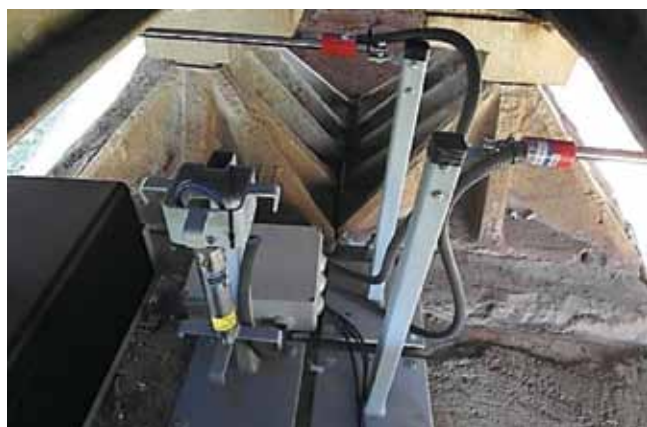
Rys. 4. Konstrukcje wsporcze do mocowania czujników kąta i czujników przemieszczeń na podporze środkowej [6] Fig. 4. Support structures for mounting angle sensors and displacement sensors at intermediate support [6]
