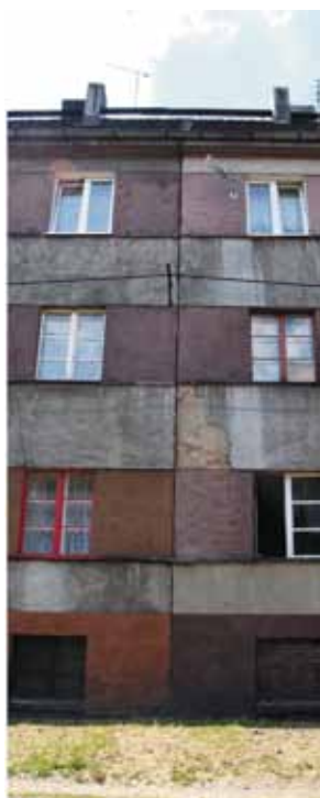
Rys. 5. Szereg „b” - zaciśnięta dylatacja pomiędzy segmentami nr 2÷4 a 6÷8 – elewacja wschodnia
