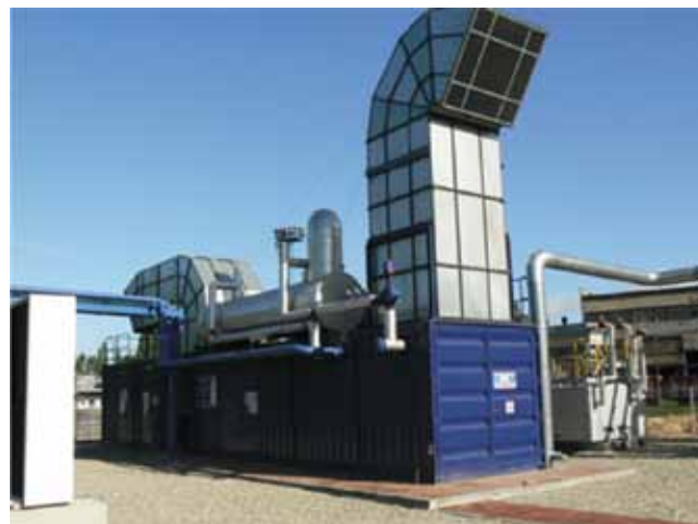
Rys. 9. Agregat prądotwórczy w KWK „Sośnica-Makoszowy” Fig. 9. Generating set in „Sośnica-Makoszowy” coal mine
