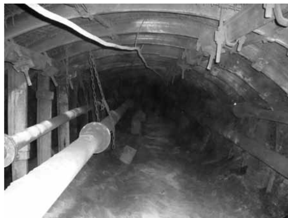
Rys. 5. Wypiętrzenie spągu za frontem ściany, przy zbudowanym pasie podporowym
