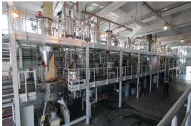
Rys. 3. Instalacja ciśnieniowego zgazowania węgla w reaktorze z cyrkulującym złożem fluidalnym. Hala technologiczna CCTW, Instytut Chemicznej Przeróbki Węgla
