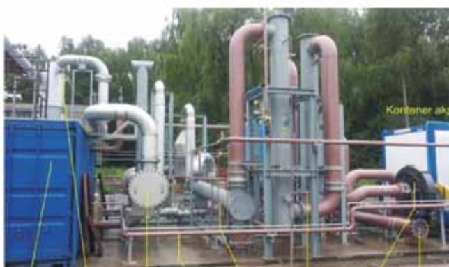
Kontener maszyn roboczych Wylot gazu z cyklonu PZW z gaz / powietrze Wymiennik z jonitów do chłodnicy wentylatorowej Woda chłodząca do chłodnicy wentylatorowej Główny kondensator smół Chłodnice pionowe Wyprowadzenie do instalacji dopalacza (przed montażem) Wentylator ciągu głównego
