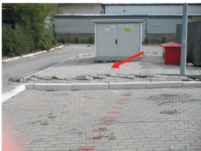
Rys. 2. Wypiętrzenie kostki brukowej w chodniku Fig. 2. Concrete cubes elevation in pavement
