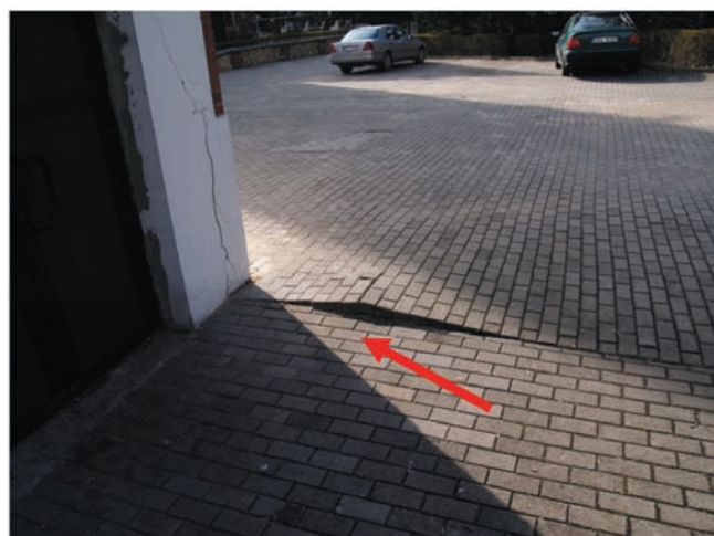
Rys. 3. Wypiętrzenie kostki brukowej na placu Fig. 3. Concrete cubes elevation on the site
