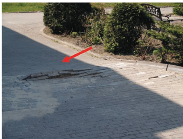
Rys. 4. Wypiętrzenie kostki brukowej w drodze Fig. 4. Concrete cubes elevation on the road
