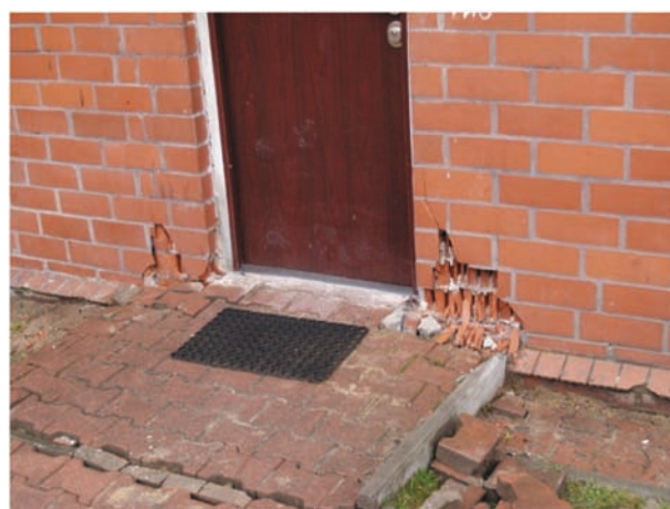
Rys. 11. Uszkodzenie cokołu w okolicy północnego wejścia do budynku D Fig. 11. Pedestal damage near the northern entrance to building D
