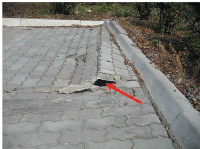
Rys. 1. Wypiętrzenie kostki brukowej i obrót krawężnika Fig. 1. Concrete cubes elevation and turn of kerb
