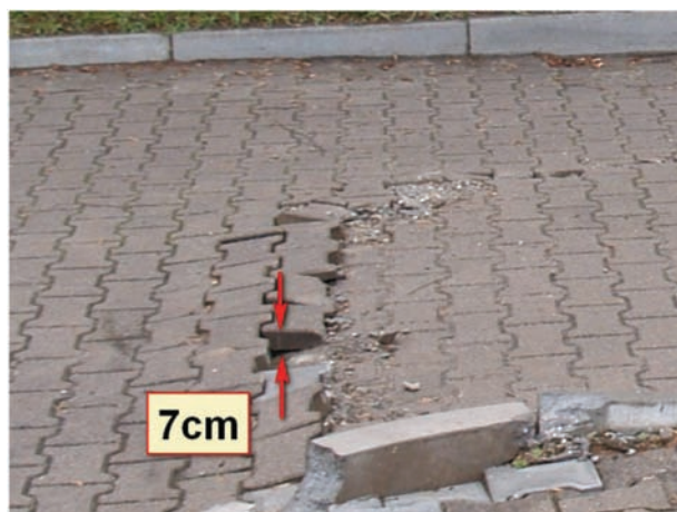
Rys. 7. Poprzeczne uszkodzenie nawierzchni drogi Fig. 7. Crosswise damage of the road surface
